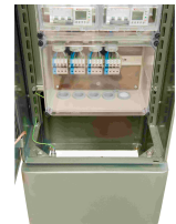
Espacio para conexiones
