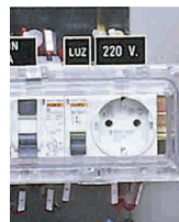
Toma de corriente
